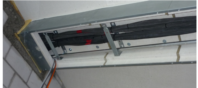
Brandschutzkanal mit 60 Minuten Feuerwiderstand aus Baustoffen der RF1 bei nicht vermeidbarer Querung eines Fluchtweges
