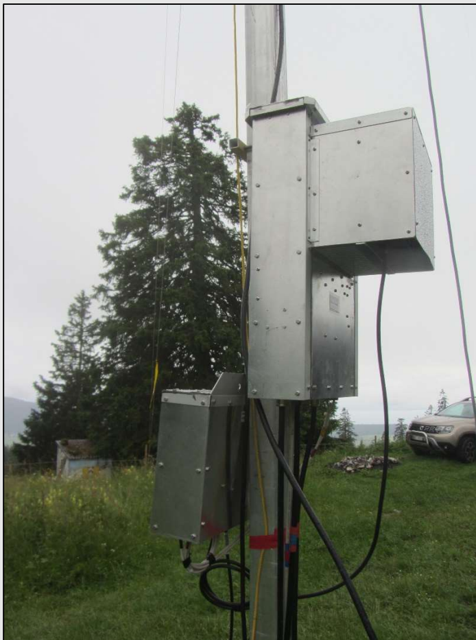
HB9N – JN37KB (NE) - 50V-Speisung, LDMOS-PA und LNA an Mast
